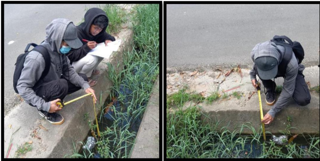
Gambar 3. Kondisi Saluran Eksisting
