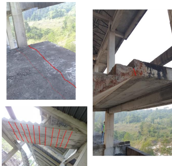
Gambar 9. Retak pada pelat tangga utama
