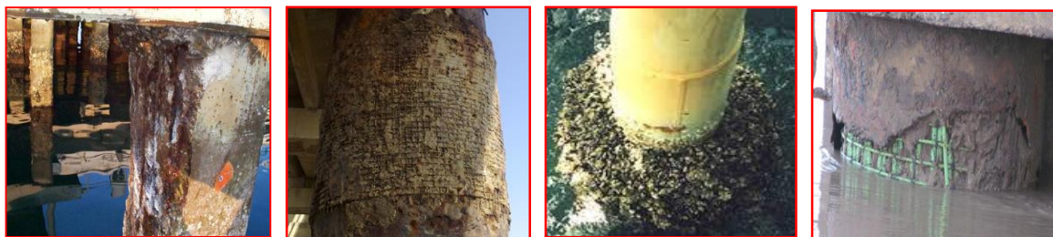
Gambar 1. Kondisi pondasi tiang bangunan dermaga RDMT sebelum perbaikan
