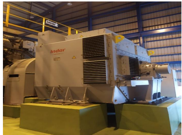
Gambar 1. Generator sinkron yang terdapat pada PLTMG Tanjung Selor
