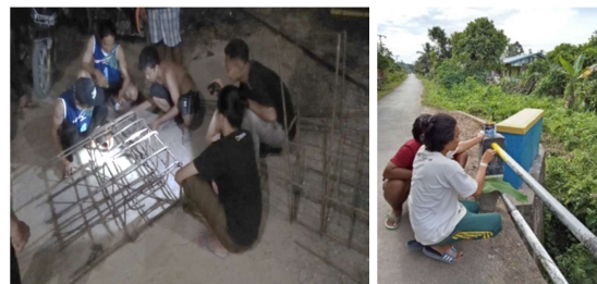
Gambar 3. Desain Rangka Perbaikan Jembatan Yang Rusak dan Peremajaan Jembatan Desa Merupakan Akses Jalan Yang Menghubungkan Dengan Desa Lainnya
