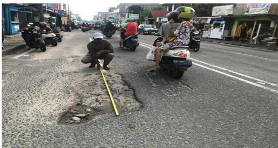
Gambar 6. Kerusakan Lubang dan Tambalan (Sumber: Survei Lapangan, 2020)
