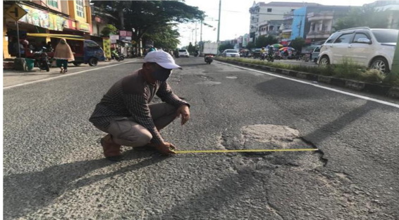
Gambar 9. Kerusakan Ambias, Alur (Sumber: Survei Lapangan, 2020 )
