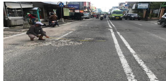
Gambar 7. Kerusakan Pelepasan Butir, Kegemukan, dan Pemisahan Agregat (Sumber: Survei Lapangan, 2020)
