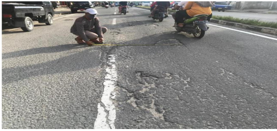
Gambar 5. Kerusakan Retak Kulit Buaya, Retak Memanjang, Retak Acak (Sumber: Survei Lapangan, 2020)
