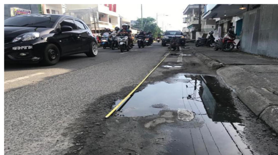
Gambar 8. Kerusakan Retak Pinggir (Sumber: Survei Lapangan, 2020)
