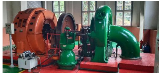
Gambar 4. Turbin PLTA Plengan Unit 5
